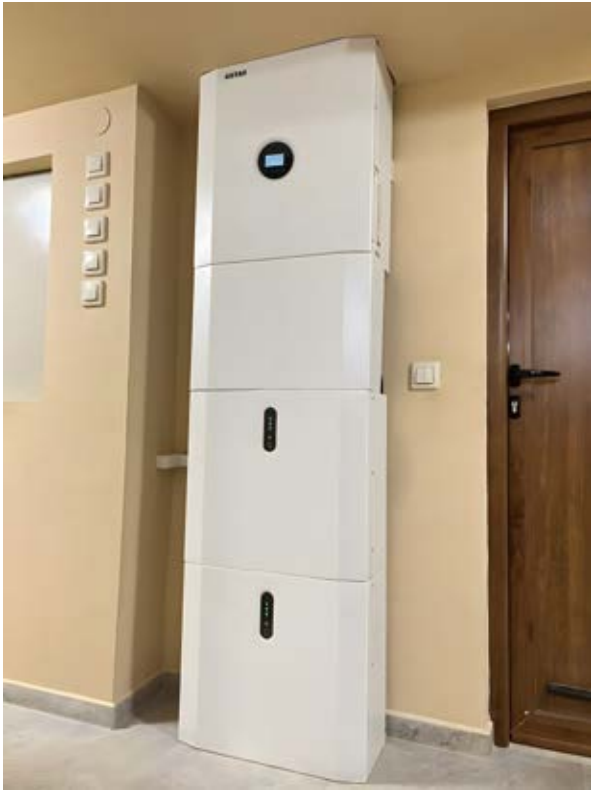
07 Progetto ESS residenziale in Bulgaria
